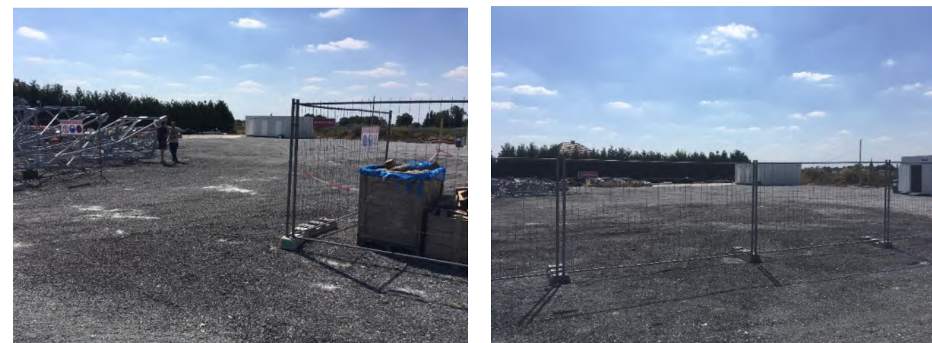
Photo 77. La base de chantier déjà aménagée qui sera utilisée pour le chantier
